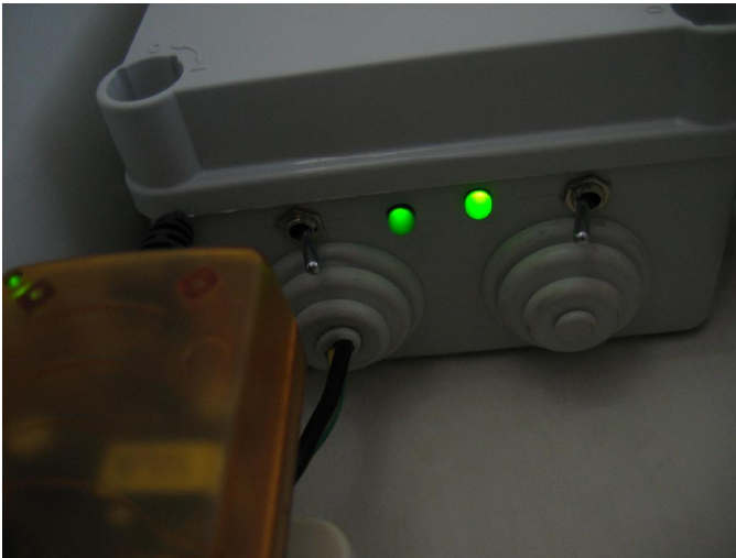
Questo è il “Pannello controllo” E’ situato chiaramente vicino alla consolle. Per ogni sensore è visibile il suo LED che segnala l’alimentazione al sensore e il commutatore a due posizioni che su una invia la tensione e sull’altra effettua il “reset” del sensore.
