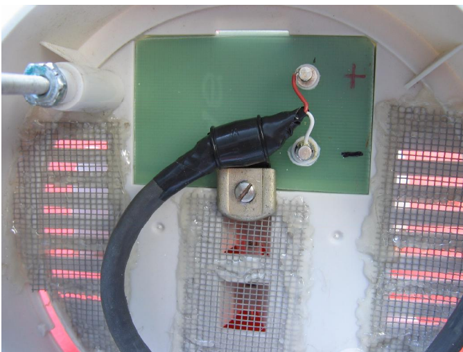
Questo è l’arrivo del cavo sul pluviio..
